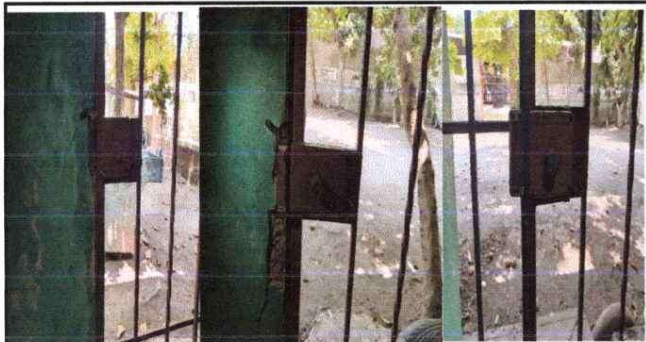
Foto 9: Sustrucción de Chapas
